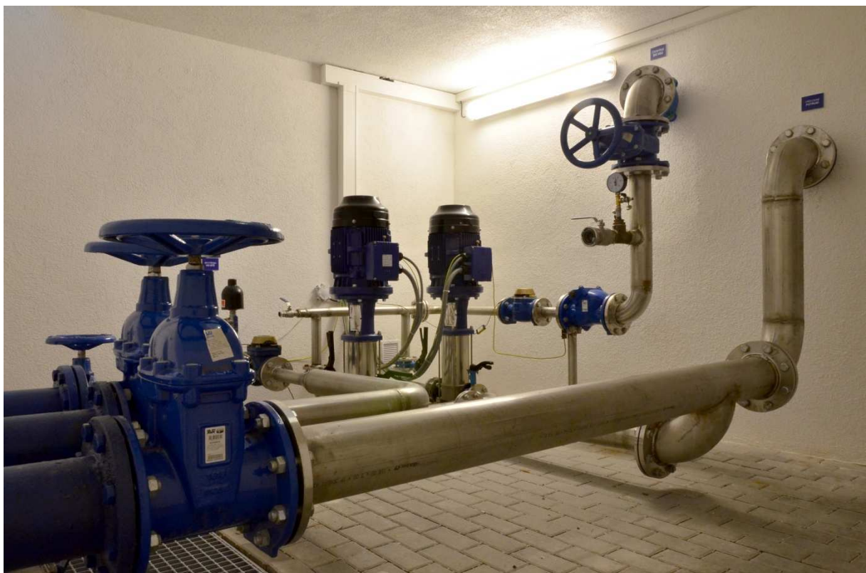
obrázek č.6 Pohled na armaturní komoru VDJ+čerpací stanice Jestřebí
